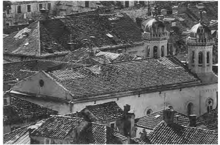
Ратна оштећења на крову Цркве Светог Благовештења, 1992. године (Фототека Завода за обнову Дубровника)
