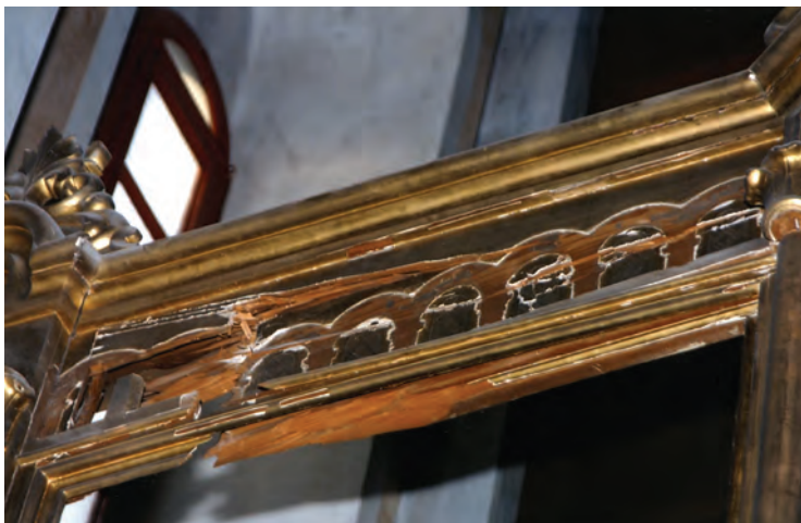
VI/2 – Оштећења на иконостасу Цркве Светог Благовештења изнад северних двери, 1993. године (Архив СПЦО у Дубровнику)
