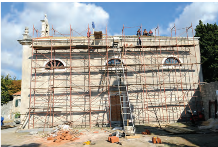
VI/10 – Радови на обнови крова Цркве Светог арханђела Михаила на Бонинову, 2010. године (Архив СПЦО у Дубровнику)
